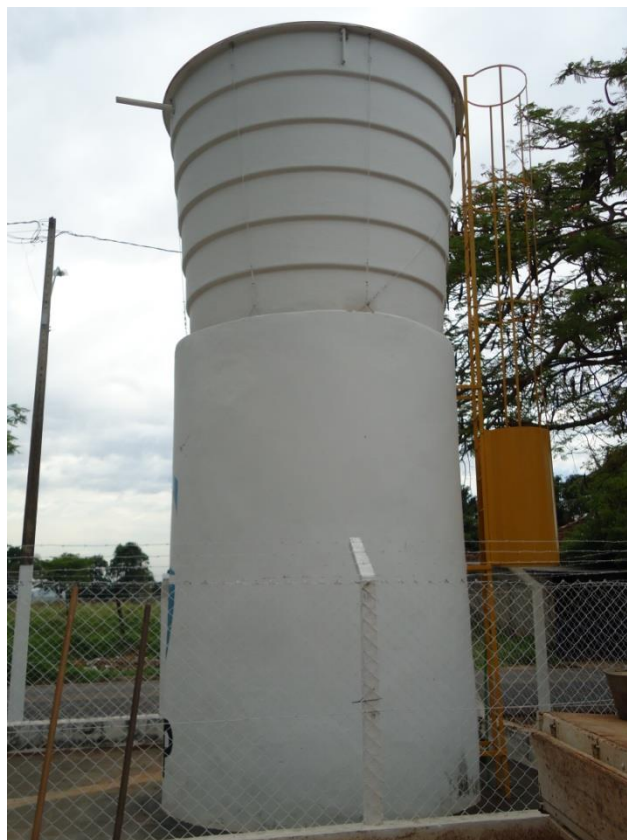
Foto 6 - Reservatório elevado de 15 m 3 (Placa 28)
