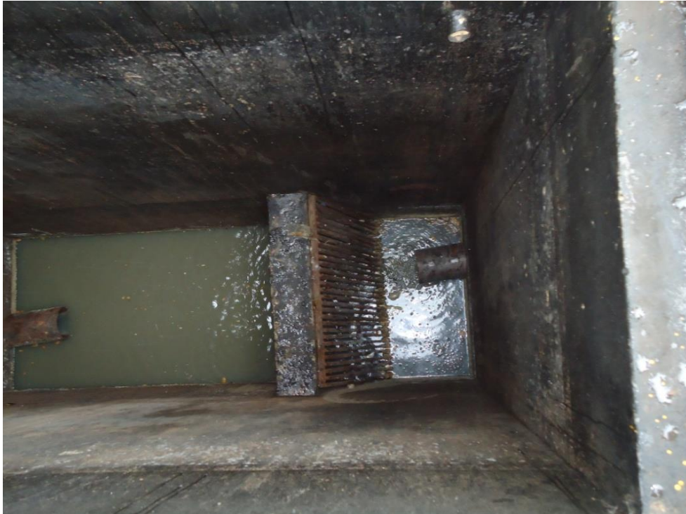
Foto 8 - Sistema de gradeamento da E.E.E. 01
