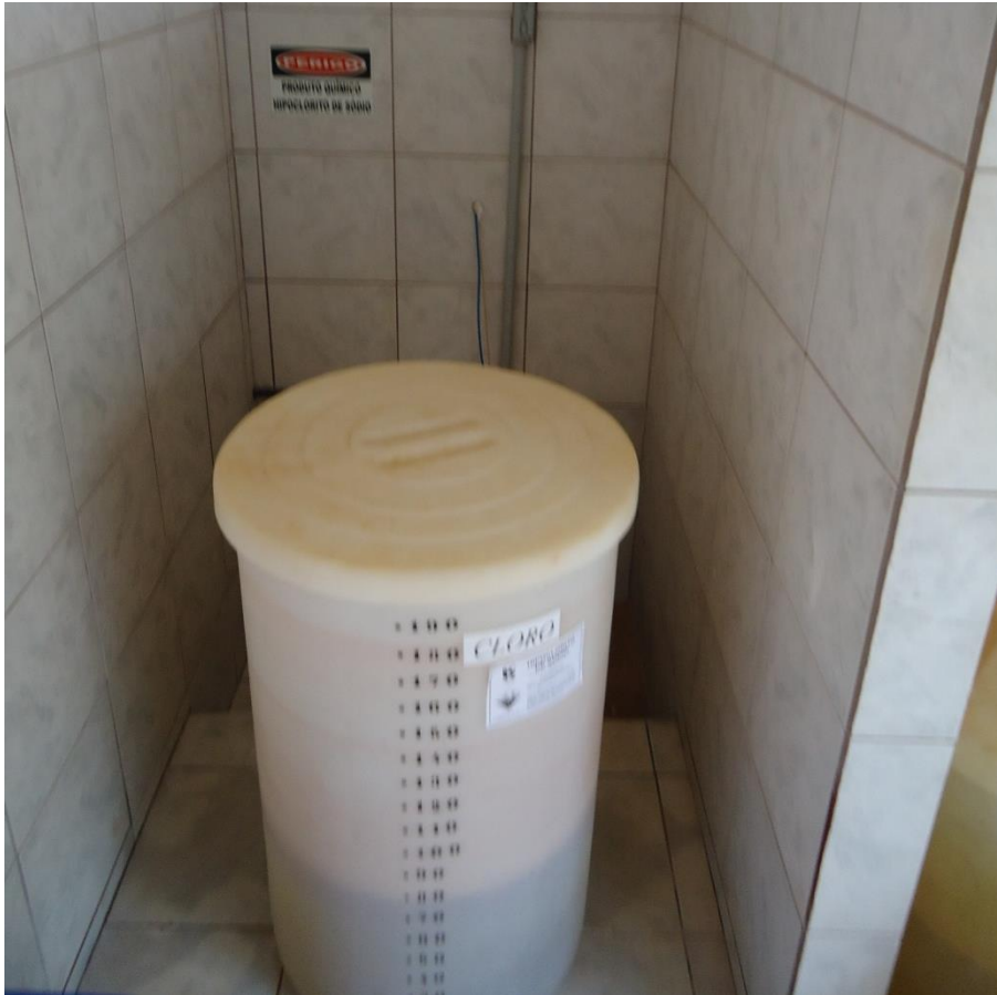
Foto 3 - Tanque de Hipoclorito de Sódio
