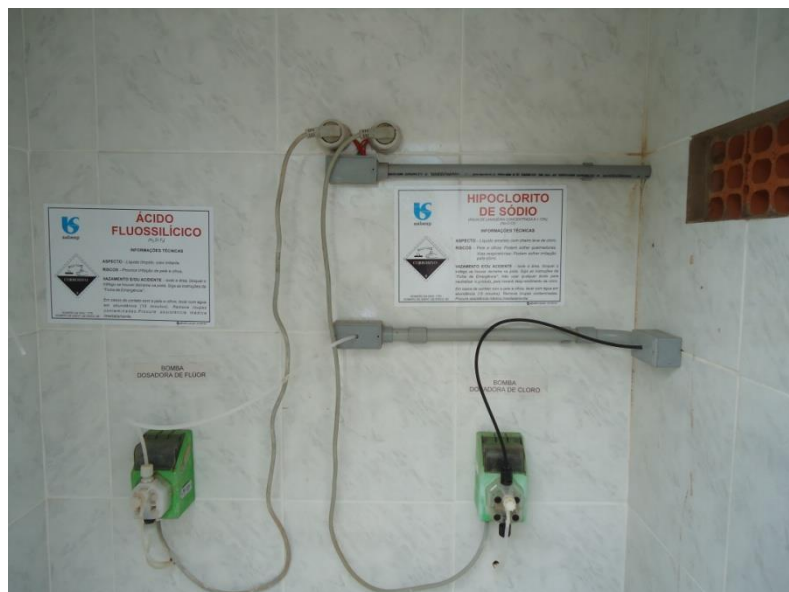
Foto 4 - Bombas dosadoras (Placa 28)
